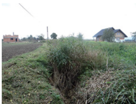
Ryc. 51. Zarośnięty rów melioracyjny – ograniczona przepustowość rowu
