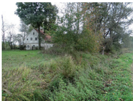
Ryc. 52. Zaniedbany rów melioracyjny – roślinność na skarpach i w rowie znacznie ogranicza jego przepustowość
