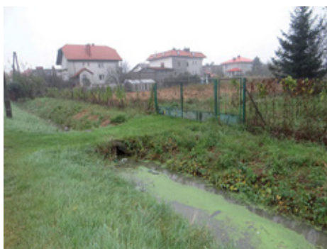
Ryc. 54. Zatkane przepusty pod dojazdami do posesji ograniczające przepustowość rowów przydrożnych
